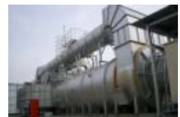
【新設した5号脱臭炉】
